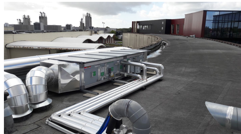
CTA avec batterie chaude et batterie froide.
